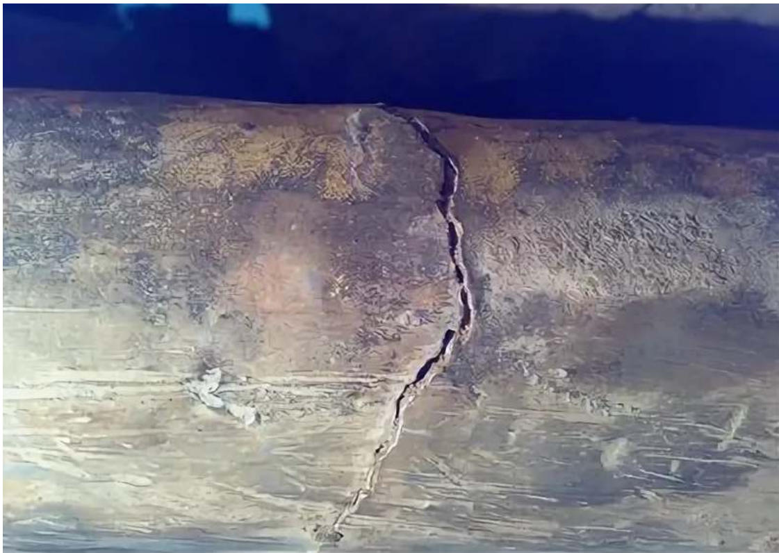
Рис. 5.7: Картина разрушения трубопровода вследствие распространения окружной трещины
