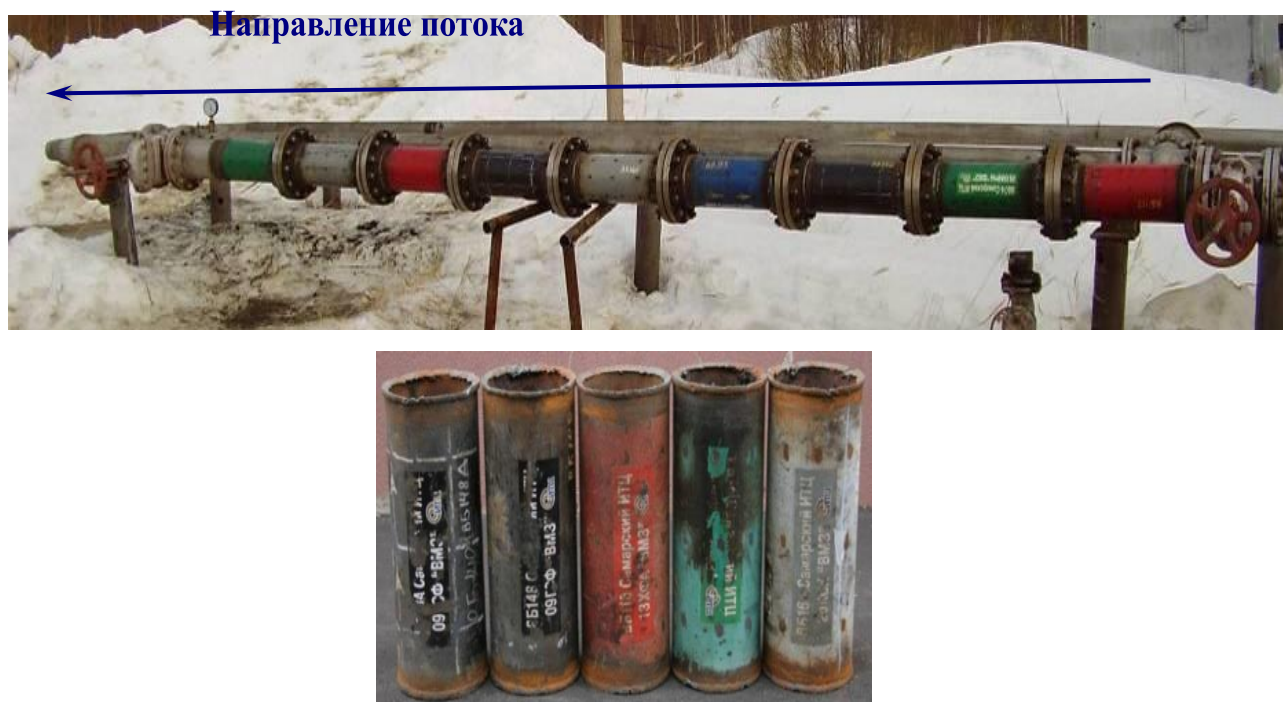
Рис. 2.5 – Байпасная линия испытания труб на нефтесборном коллекторе к.34А Мамонтовское месторождение ООО «РН-Юганскнефтегаз» и катушки, вырезанные из труб
