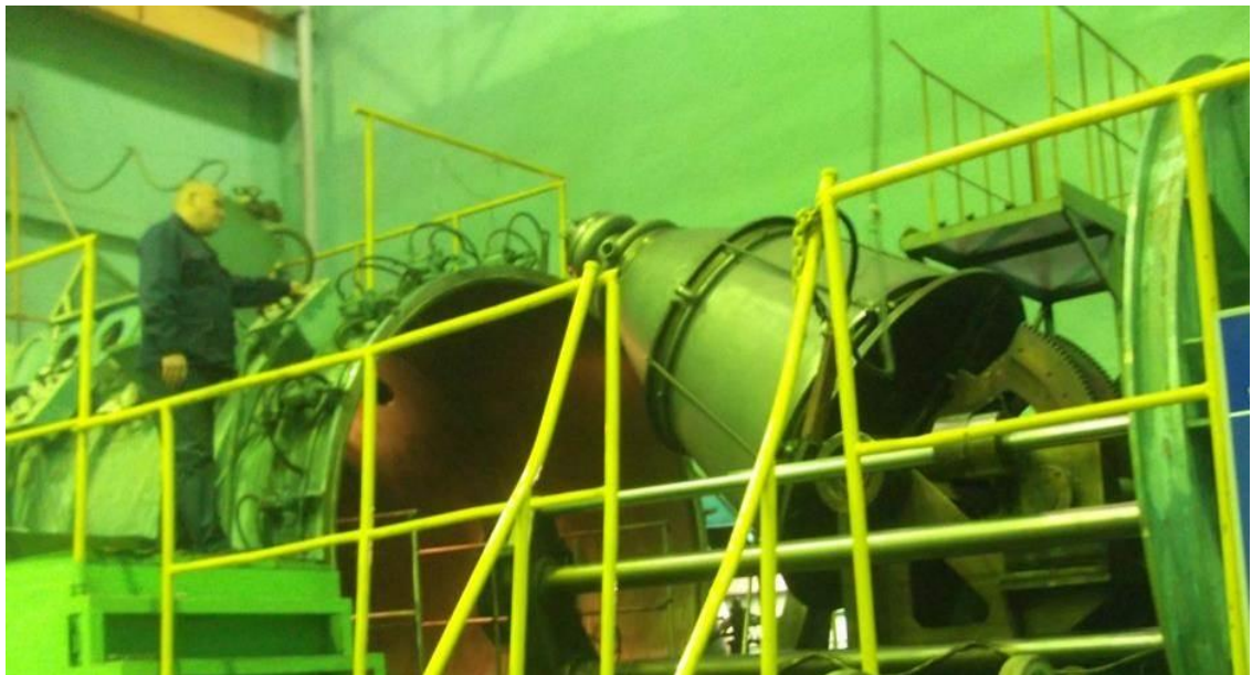
Рисунок 2.13 - Общий вид установки ЭЛУ-11
