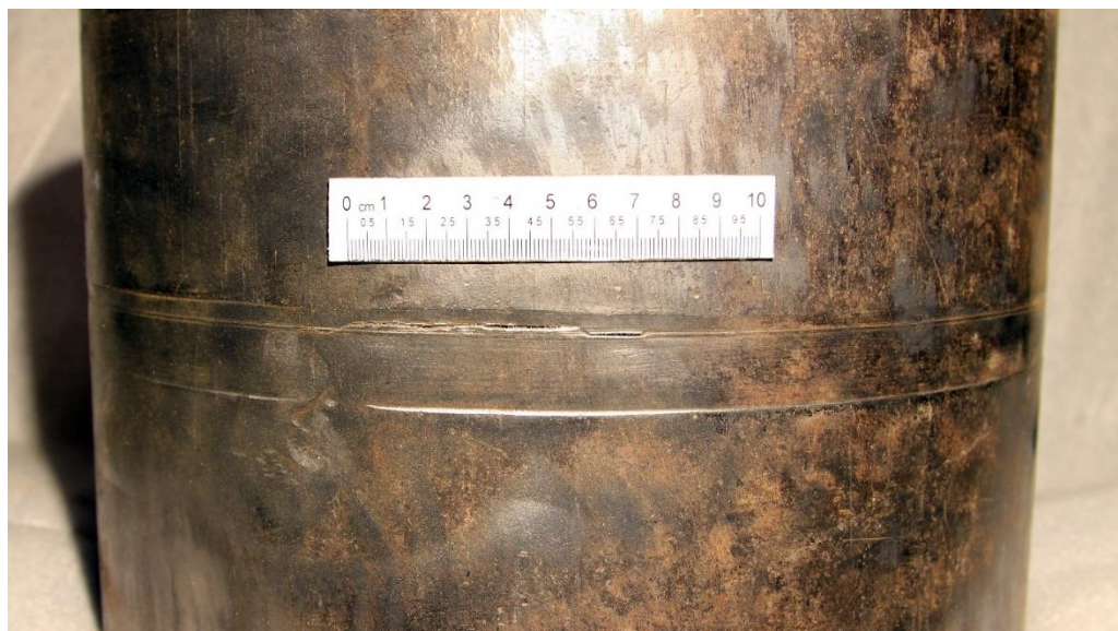
Рисунок 2.5 – Вырезанный дефектный участок трубы с трещиной
