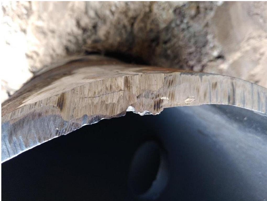
Рисунок 2.6 – Торец вырезанной трубы с внутренним дефектом
