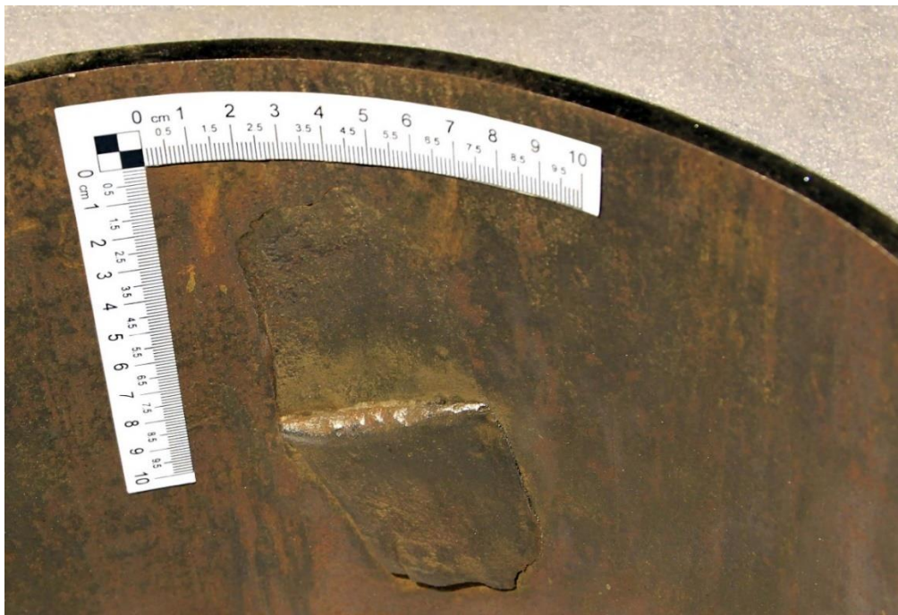
Рисунок 2.4 – Внешний вид отслоившегося участка на теле трубы
